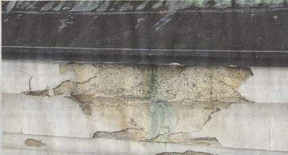
Vom Gesims des Kupferdaches der Pfarrkirche in Tutzing fielen immer wieder Steinbrocken nach unten, weswegen dringender Handlungsbedarf bestand.
